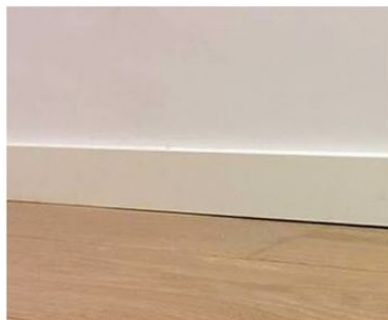
Glooiing in een PVC vloer
