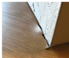
Wand niet goed afgewerkt
