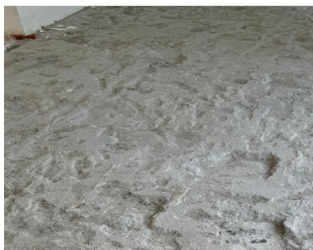
8 - Zware beschadigingen aan de basisvloer na sloopwerkzaamheden:
