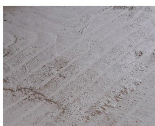
10 - Niet correct dichtgesmeerde sleuven van ingefreesde vloerverwarming. Een veelvoorkomende fout is dat de sleuven worden gevuld met tegellijm of egaline in plaats van een krimpvrije mortel :
