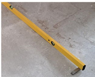
7 - Grote niveauverschillen in de basisvloer zelf. Te grote hoogteverschillen kunnen er voor zorgen dat de vloer niet kan worden gelegd.
