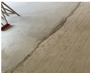
6 - Grote niveauverschillen in de aansluiting met andere ruimtes:
